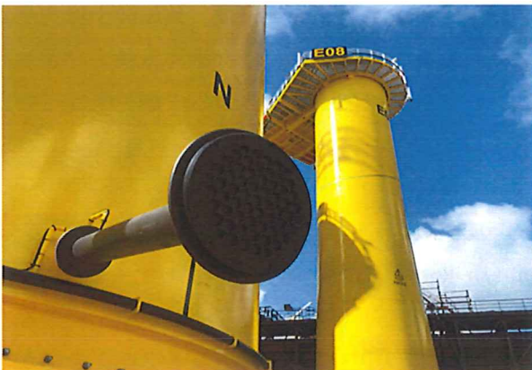
ICCP システム (External 用通電電極)
