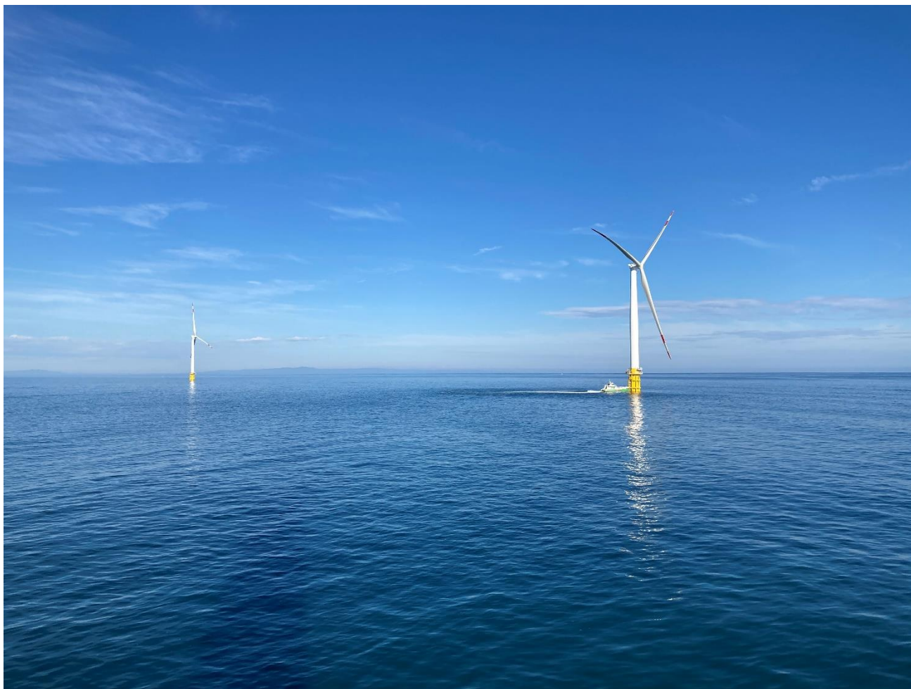
流電陽極方式による電気防食が据え付けられた支持構造物と洋上風力発電設備（富山県入善町沖）
