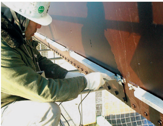
堰施設に取り付けられたアルミニウム合金陽極
