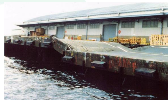
栈橋鋼管杭の腐食により穴が開き、座屈した結果、上部エコンクリートが陥没
