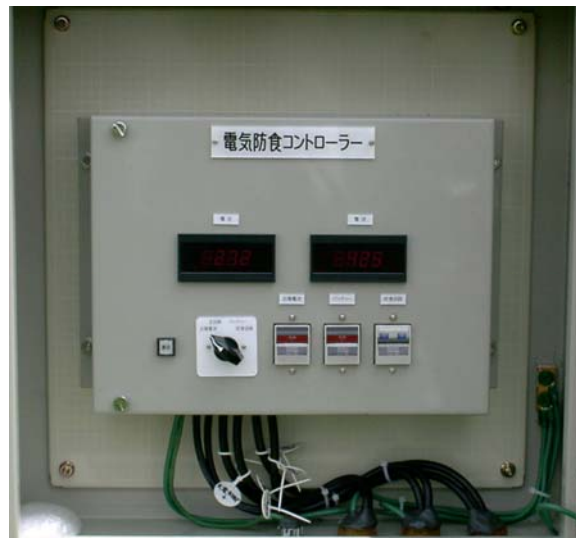
写真 4. 制御装置 (電気防食コントローラー)
