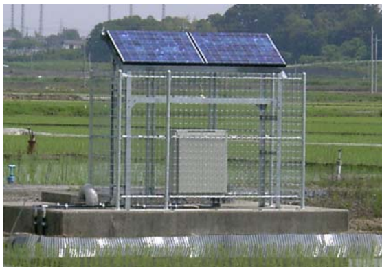
写真 1. 太陽光発電システム全景
