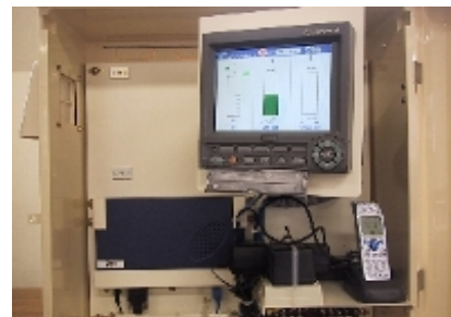
写真6. 遠隔監視装置
