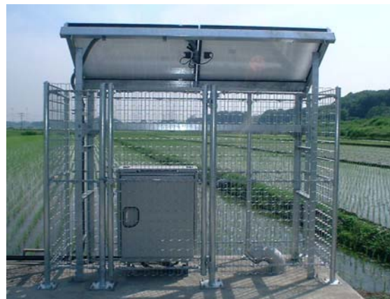
写真 2. 太陽光発電システム全景
