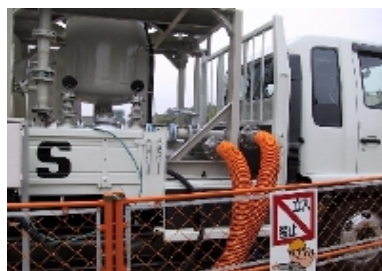
写真12. ユニット内配管 取合点
