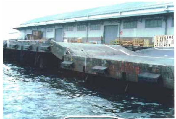
写真3. 横浜港山下埠頭棧橋の陥没事故状況
