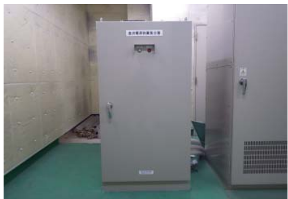
写真 7 直流電源装置
