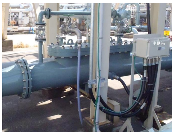
写真2 軸冷海水配管適用事例
