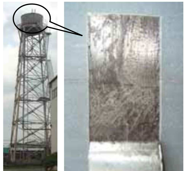
図10 屋外高架水槽にZAPテープを貼り付けてから15年経過した後の状態
