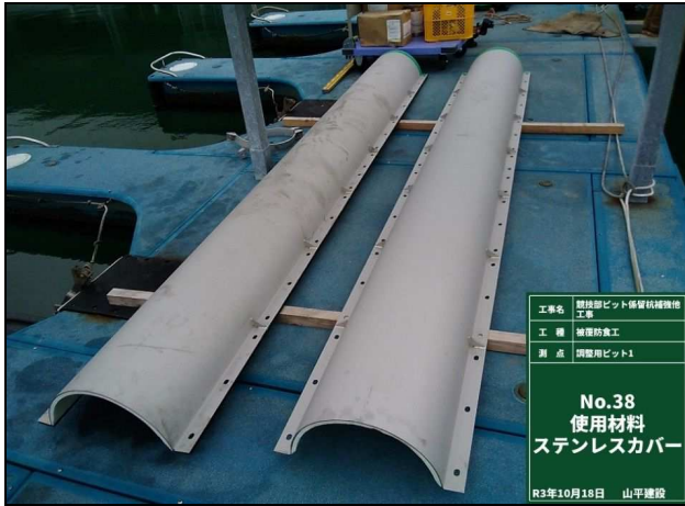
写真7 ステンレス鋼製カバー
